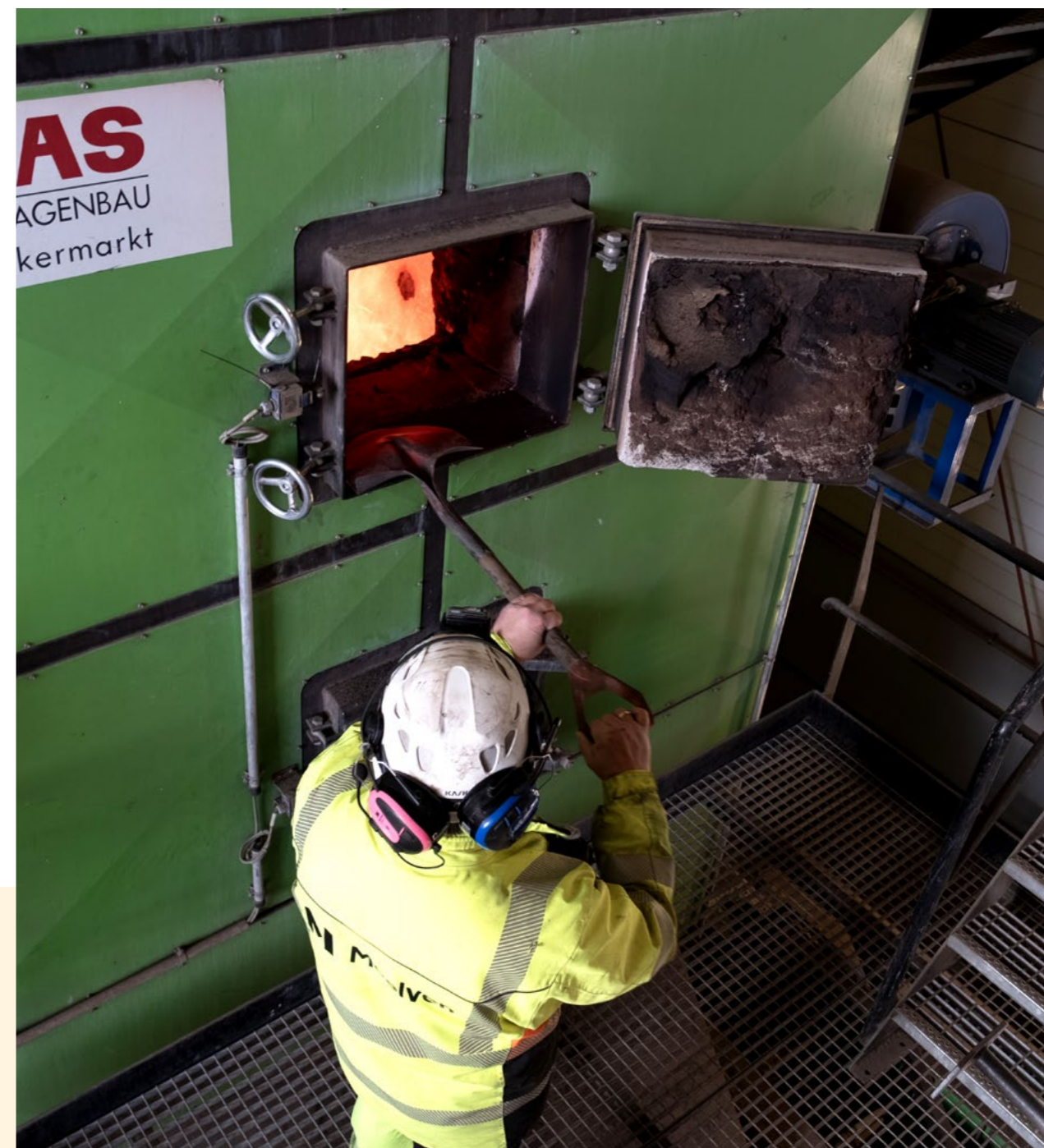
Visuell kontroll av förbränningen. Temperaturen i förbränningskammaren kan nå upp till 1000 grader C.
